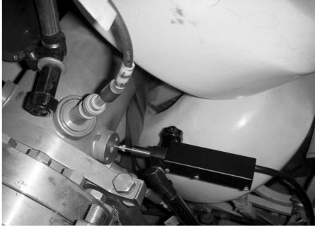
图3 BPM真空室位移测量系统实物图
